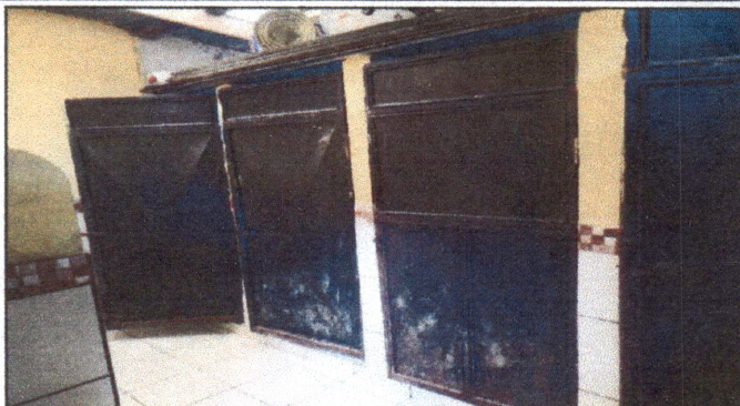
Foto 8: Módulo Baños, pintura y lámina de puertas en mal estado.
