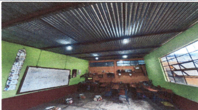
Foto 2: Aula del módulo 4, Cubierta de lámina en mal estado, sustitución de lámina acanalada por lámina troquelada.
