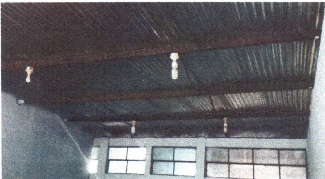
Foto 3: Aula del módulo 4, Estructura de techo en mal estado necesita mantenimiento y sustitución de lámina acanalado por lámina troquelada
