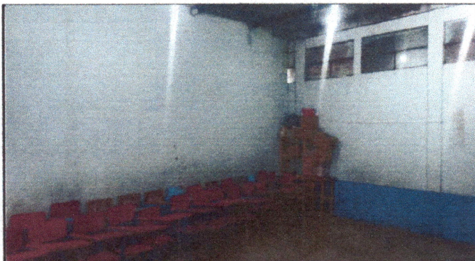
Foto 9: Módulo 4, Pintura en paredes interior en mal estado.
